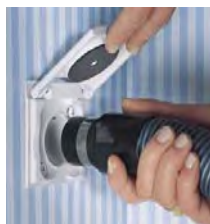
ein Loch in der Wand
